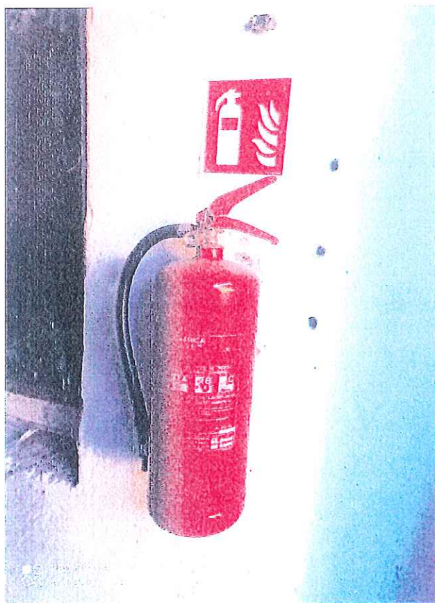
Zdjęcie nr 10 Sposób rozmieszczenia i oznakowania podręcznego sprzętu gaśniczego.
