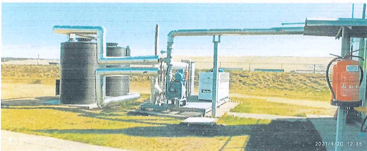
Część instalacji do odzysku biogazu
