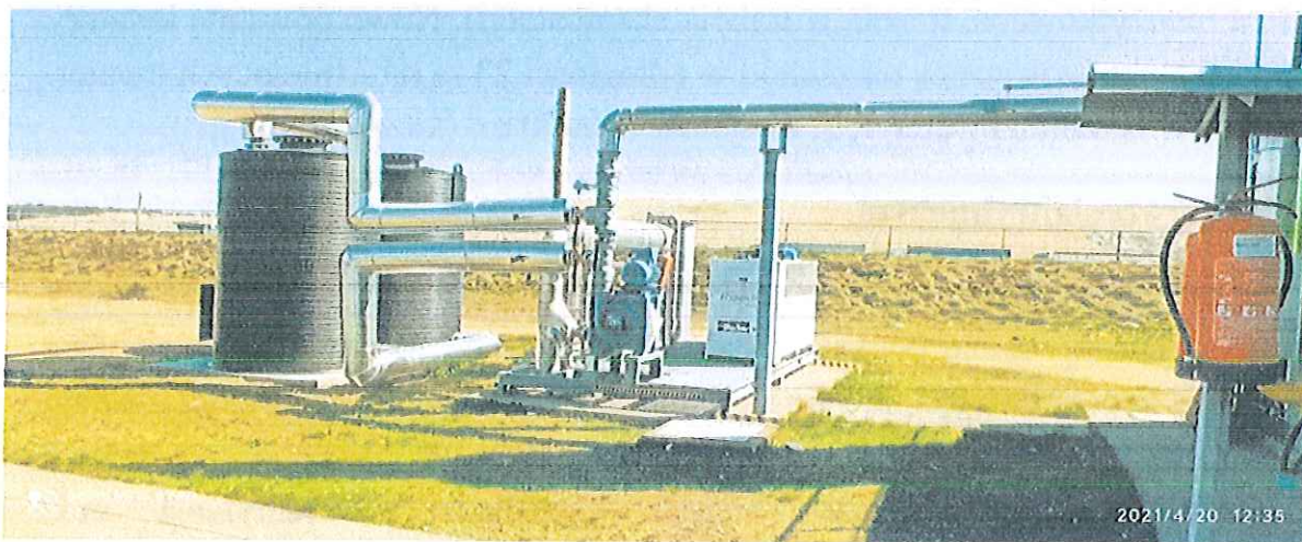
Część instalacji do odzysku biogazu
