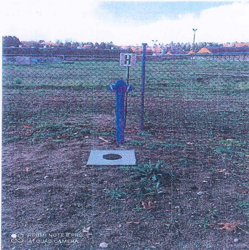
Zdjęcie nr 10 Hydrant nadziemny znajdujący się poza ogrodzonym terenem fermy przy drodze prowadzącej do Biogazowni.
