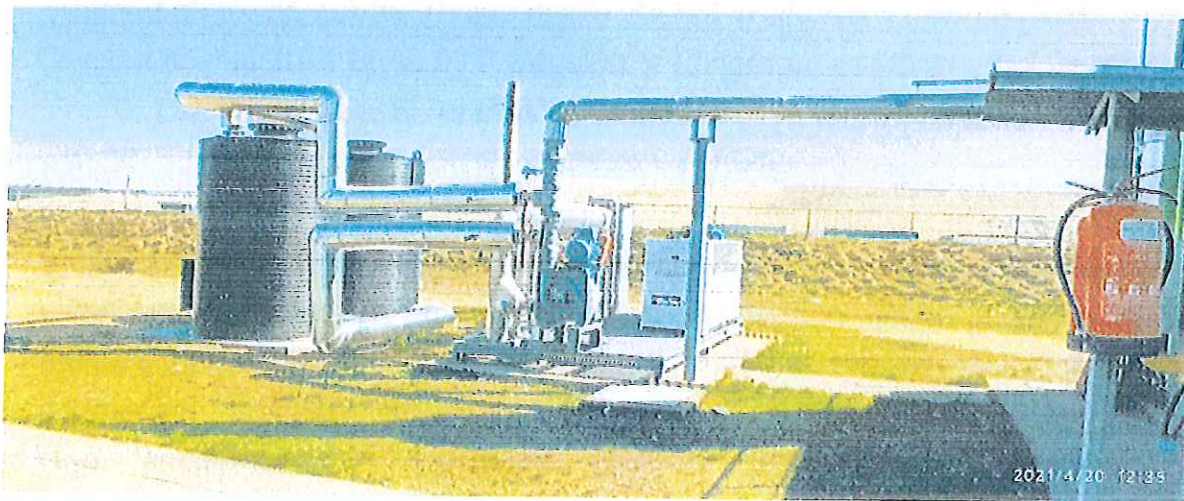
Część instalacji do odzysku biogazu
